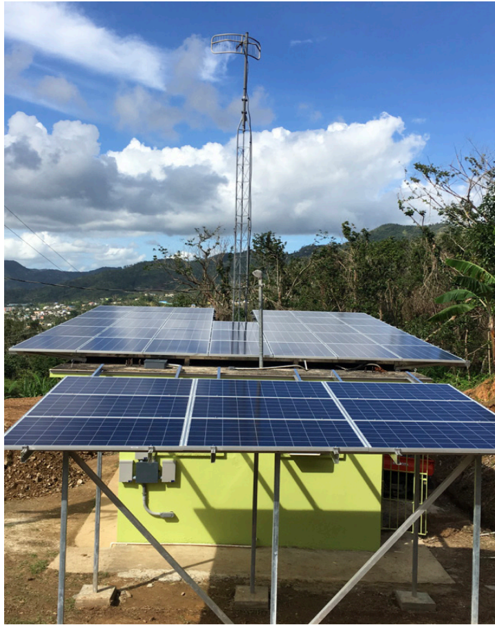
Figura 2. El primer transmisor de Puerto Rico y el Caribe, Radio Casa Pueblo opera sus estudios y la torre de comunicaciones 100% con energía fotovoltaica.
