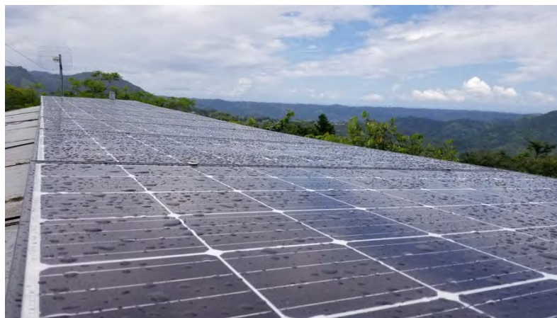
Figura 3. Un total de cinco colmados en barrios distantes fueron energizados con sistemas autónomos fotovoltaicos. Estos lugares representan las primeras líneas de defensa alimentaria para la gente de nuestros campos.
